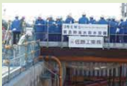
緊急時海水取水設備
